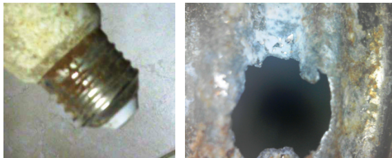
Fig. 4: Imagen que muestra lámparas con niveles de corrosión elevados sobre el casquillo de latón.
